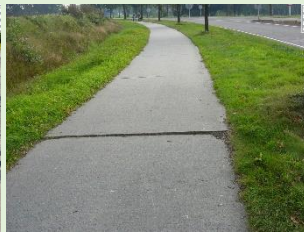
Oneffenheden beton (C)
