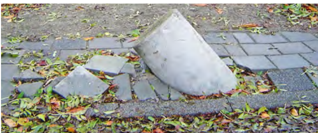
Losliggende tegels zijn slecht zichtbaar voor de doelgroep.
